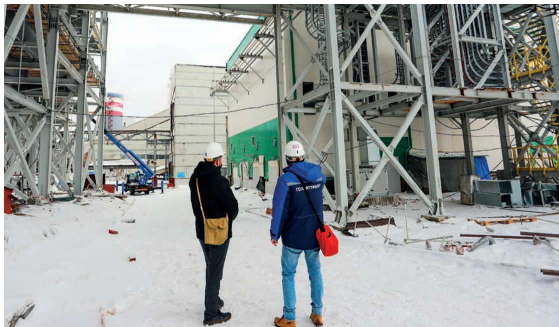
Первым объектом, запущенным в строй на новом агрегате, станет электроподстанция
