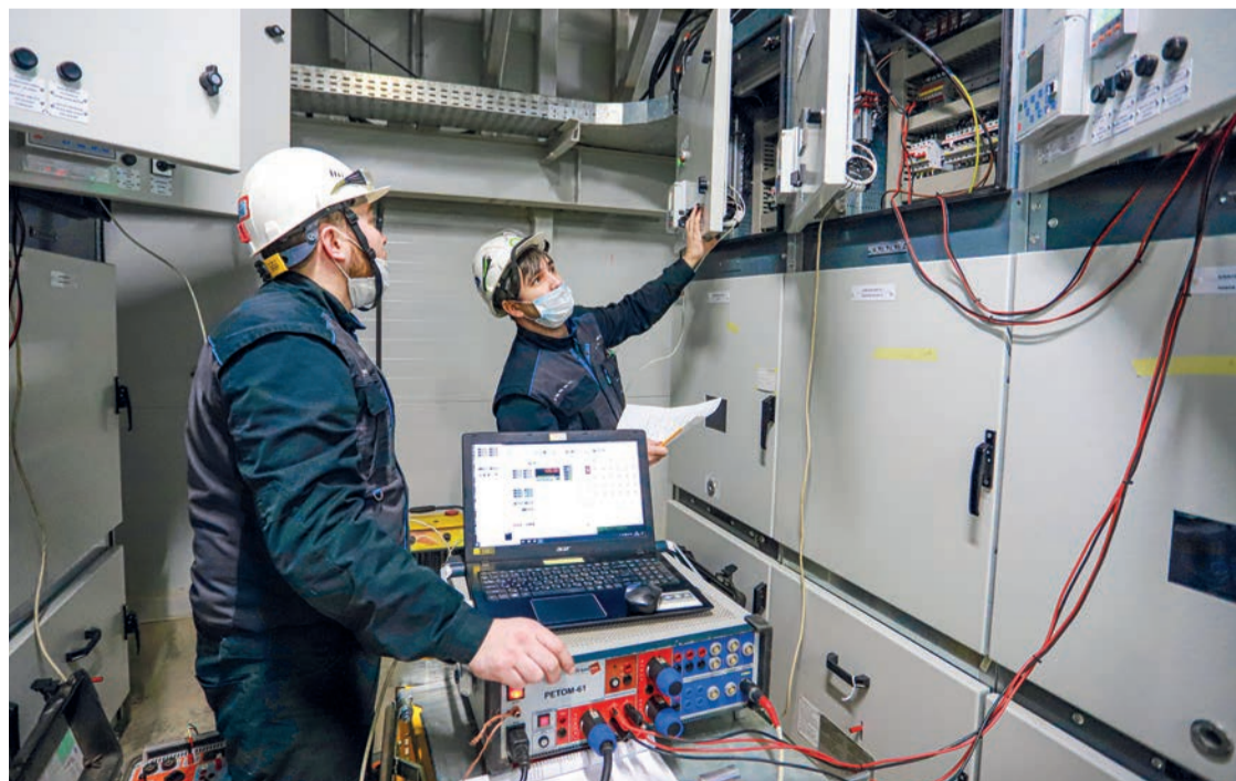
На подстанции будут использовать современные распределительные устройства и трансформаторы
